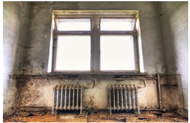
Alte Heizungen – vielleicht noch älter als 18 Jahre..., © fotolia
