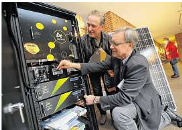
Hans-Jörg Becker (rechts) erklärt Heiner Bollmer das Batteriespeichersystem einer Photovoltaikanlage.
